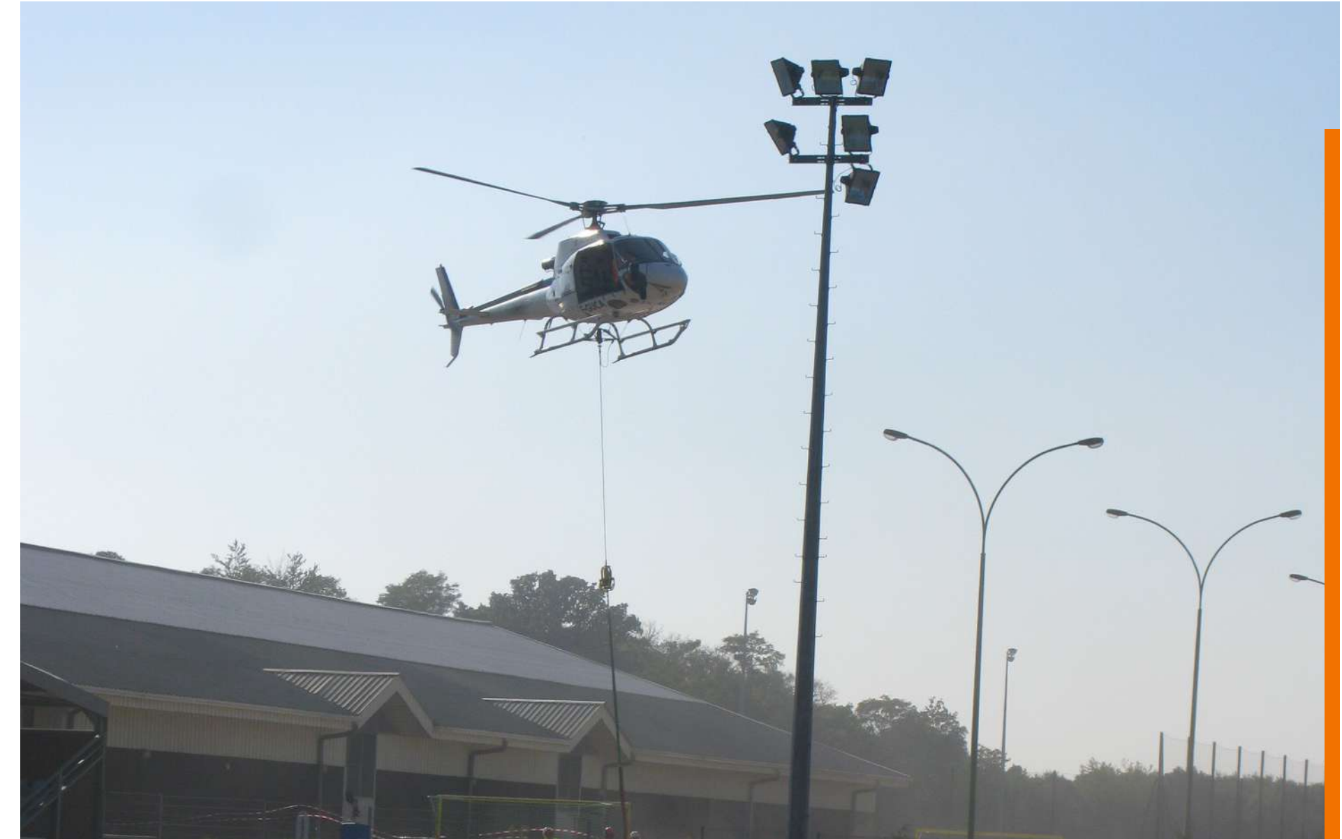
Hélicoptère et levage de de mâts du complexe sportif du Camp des Loges de Saint-Germain-en-Laye.
